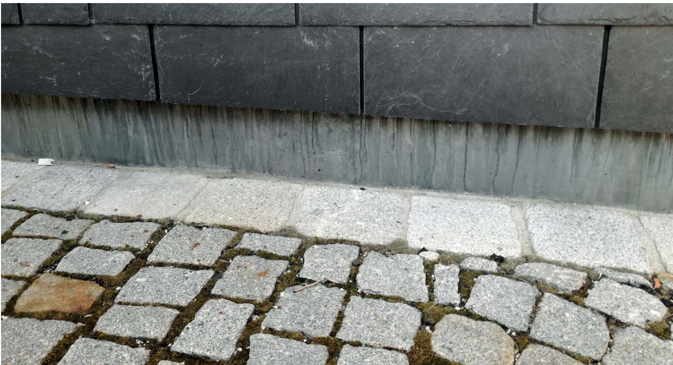
Abbildung 40: Abdichtung des gefährdeten Sockelbereichs mit Blecheinfassung. Die darüber liegenden Schieferplatten dienen als optisch ansprechende Wandverkleidung.
