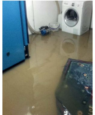
Abbildung 8: Eindringen des Wasser, versetzt mit Schlamm, kann große Schäden an Gebäuden verursachen.
