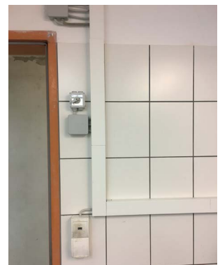
Abbildung 64: In gefährdeten Räumen sollten elektrische Leitungen unbedingt an der Decke verlegt werden. Als Wandverkleidung empfehlen sich Fliesen. Sie erlauben eine einfache und rasche Reinigung nach einem Wasser- oder Schlammeintritt.
