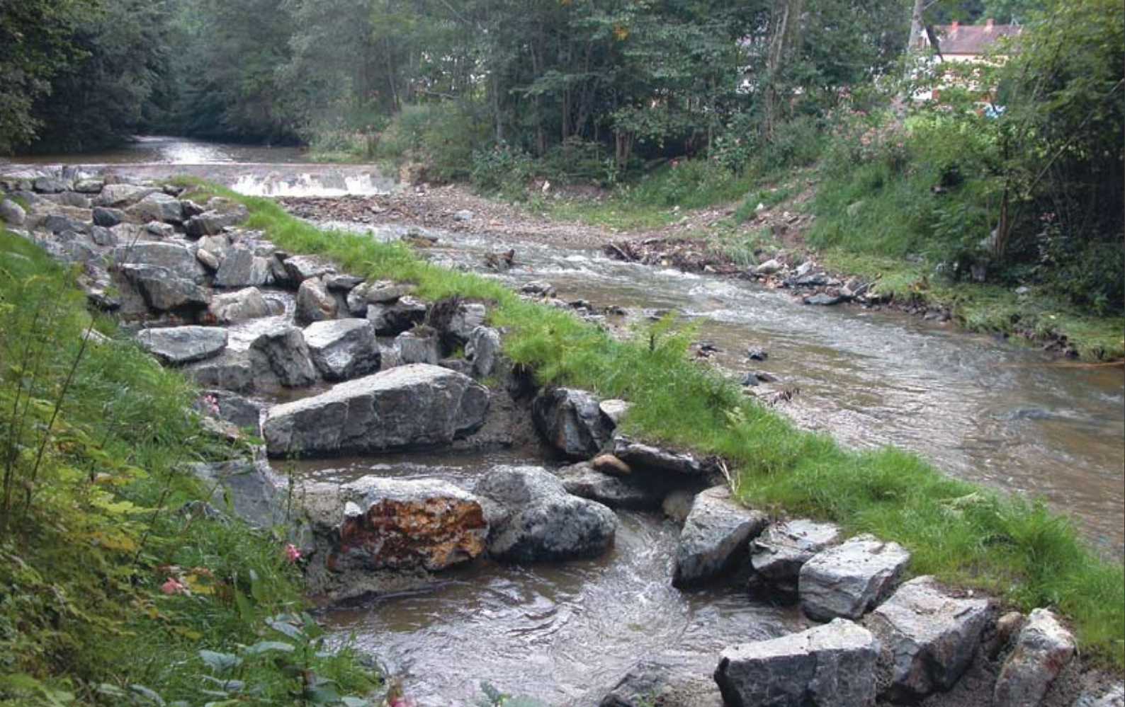
Die Tümpelpässe im Hochwasserabflussbereich wurden sehr massiv gebaut, um dem Hochwasser stand zu halten (z.B. FWH Lafnitzmühle, Gem. Riegersberg, St. Lorenzen am Wechsel).
