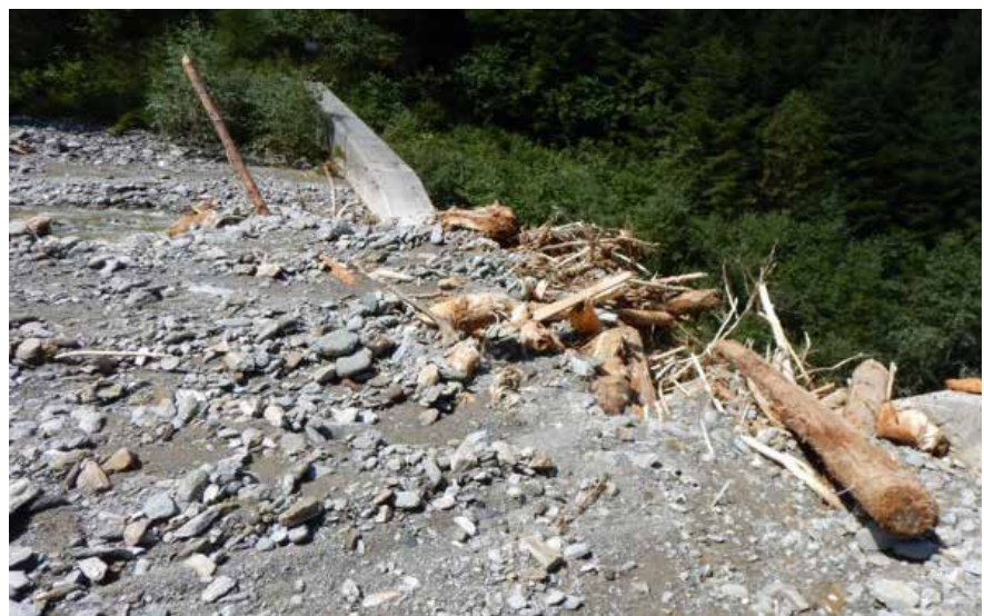
Abb. 7: Verfüllter Murbrecher im Finsterkarbach im Donnersbachtal © WLV
