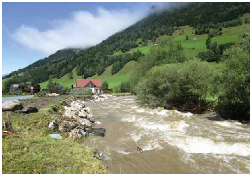
Abb. 2: Massive Uferabbrüche am Sölbach © A14
