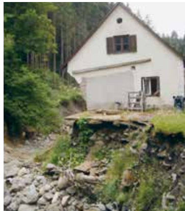
Abb. 1: Durch einen Wildbach weggerisener Hausteil (Quelle: ABT14/WWP).
