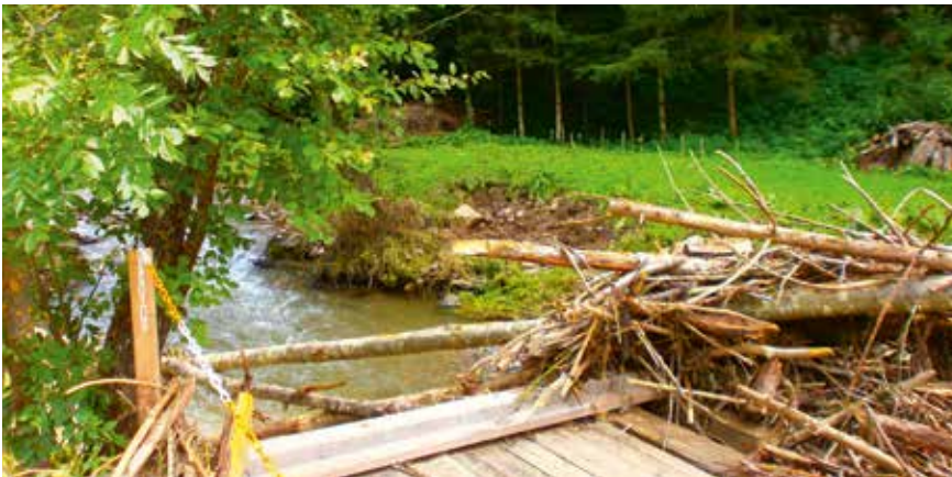
Im Rahmen der Gewässerzustandsaufsicht werden Uferschäden und Verkläunungen erfasst © BBL
