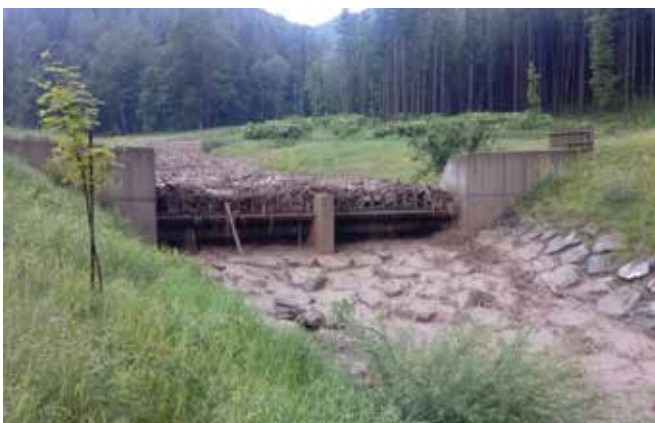
Abb. 1: Geschiebesperre am Kleinen Fölbach bei Höhenmeter 8,5 verhinderte massive Schäden im Siedlungsraum © WLV
