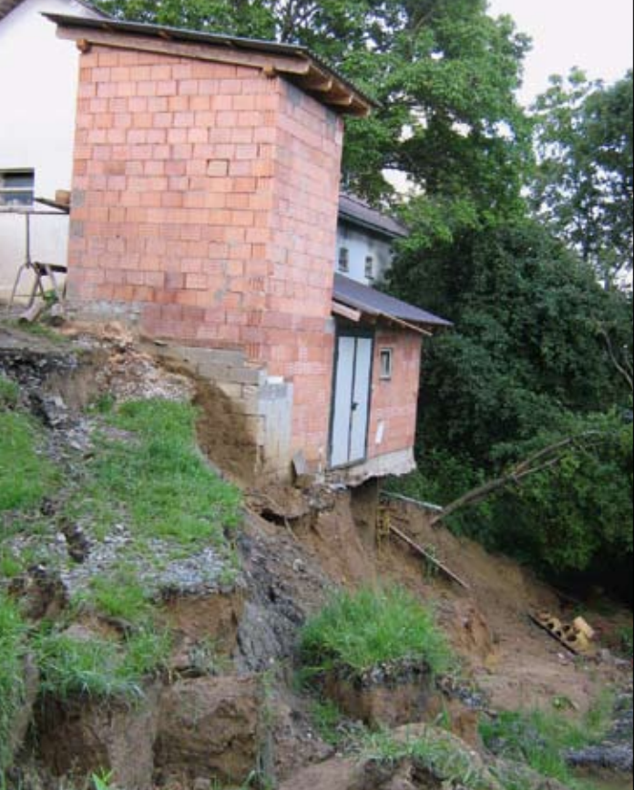
Hangrutschung in der Gemeinde Söchau
