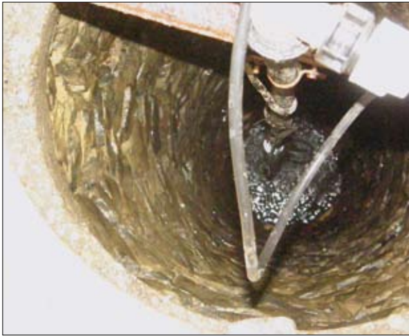
Abb. 4: Mit Steinen ausgekleideter Brunnenschacht, Eindringen von Oberflächenwasser
