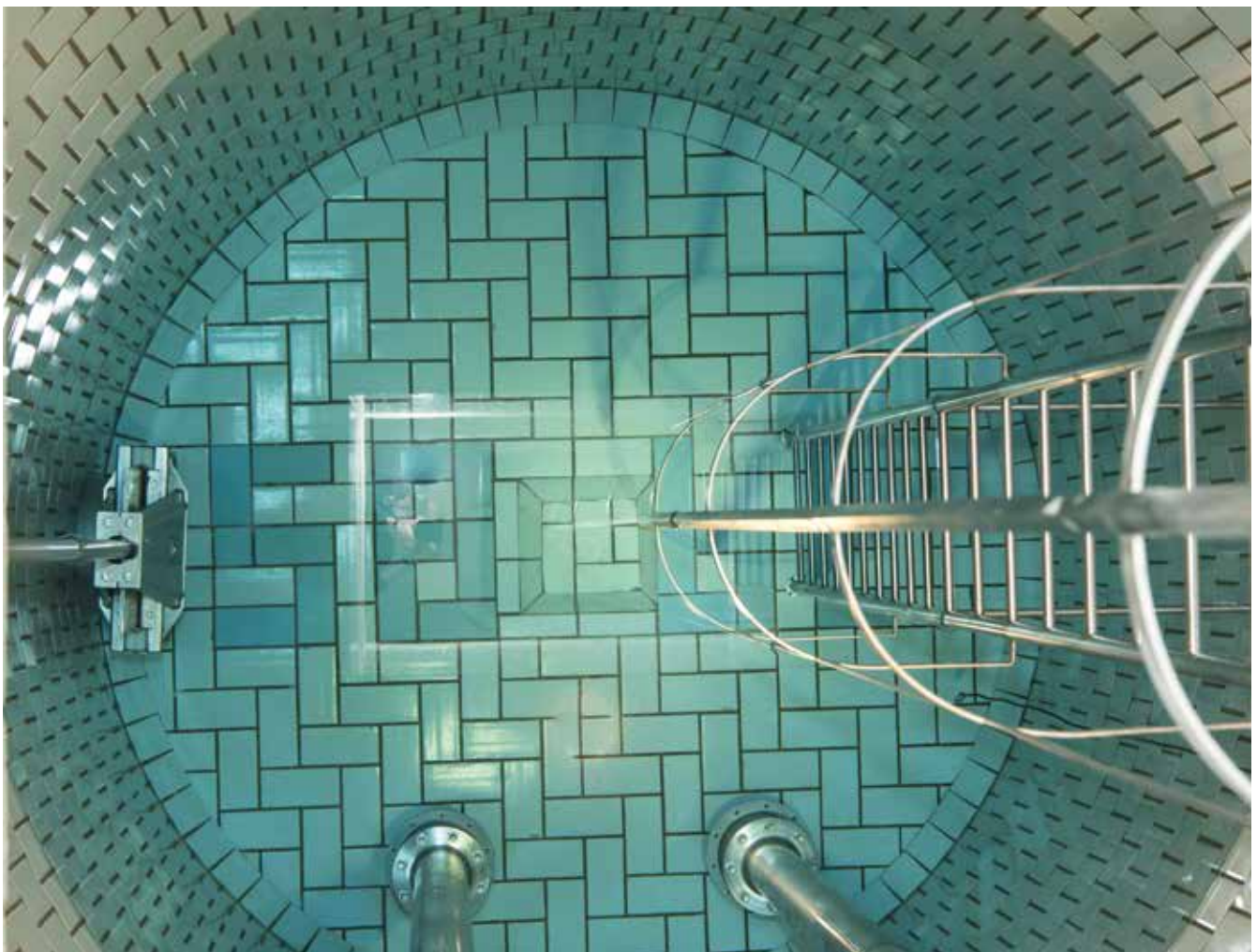
Abb. 4: Ein moderner Brunnen für die öffentliche Trinkwasserversorgung © Leibnitzerfeld Wasserversorgung GmbH
