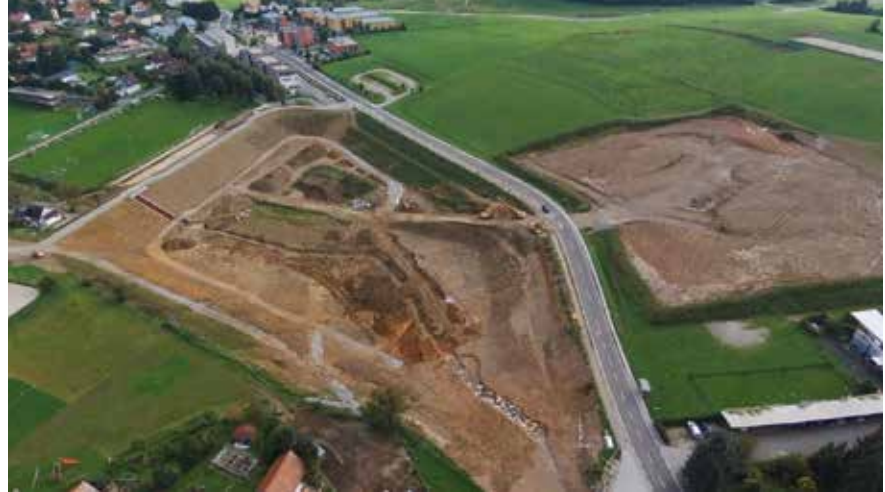
Abb. 2: HWRHB Andritzbach während des Baues, HWRHB Höllbach am oberen Bildrand bereits fertiggestellt, Frühjahr 2018 © WLW
