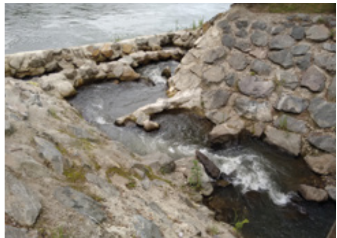
Abb. 18: Beckenpass als FAH-Einstieg beim KW Obervogau © Abteilung 14
