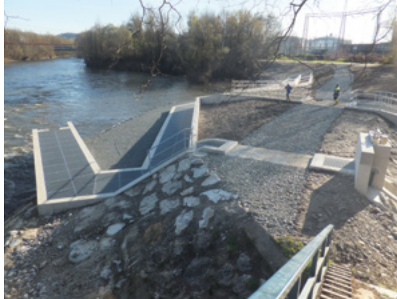
Abb. 23: Schlitzpass mit Gitterabdeckung am unteren Ende der FAH des KW Mellach © Schmid / IB Parthl
