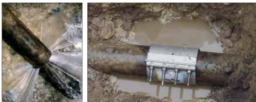
Abb. 3: Rohrschaden und Reparatur mit einer Rohrschelle (Fotos: Wiener Wasserwerke)
