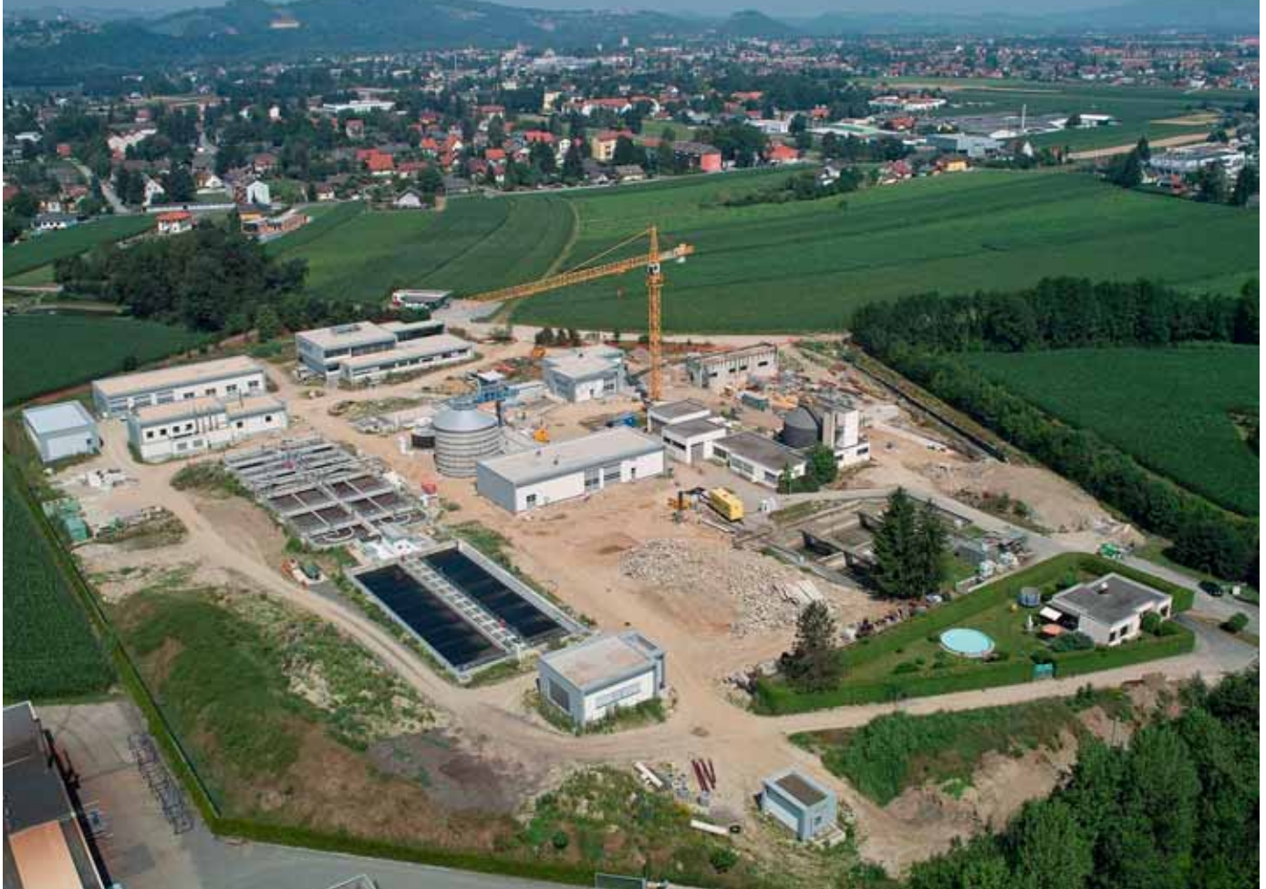
Abb. 3: Die Erhaltung der abwassertechnischen Infrastruktur am Stand der Technik, eine ständige Herausforderung - Kläranlage Leibnitz
