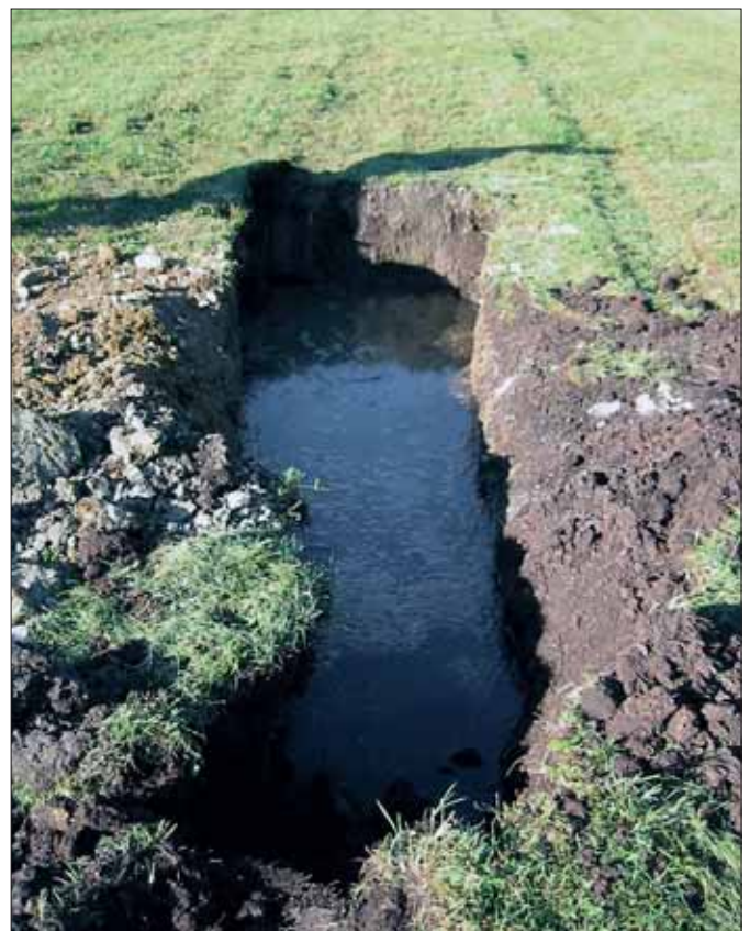
Abb. 1: Probeschürfe zeigen Grundwasser nahe der Geländeoberfläche
