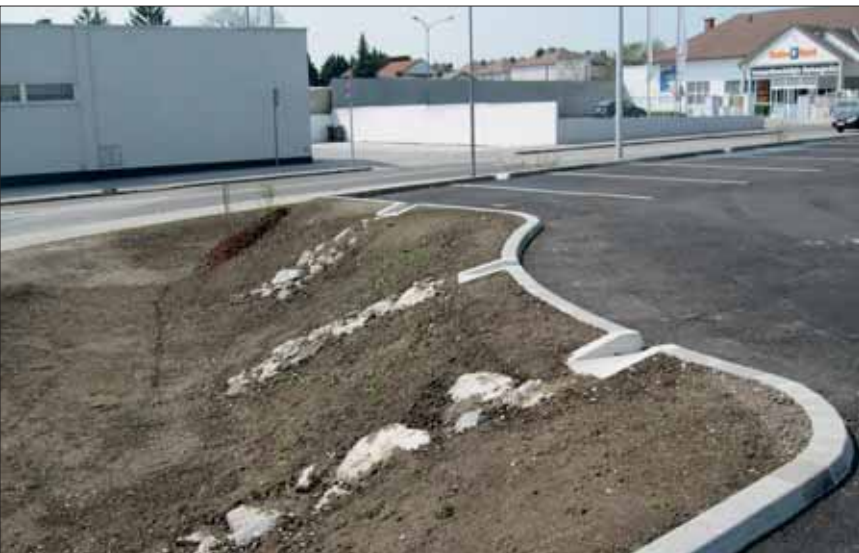
Abb. 7: Parkplatzentwässerung über Rasenmulden (Foto: G. Gruber)
