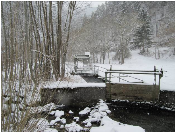
Abb. 25: Wehranlage KW Fally
